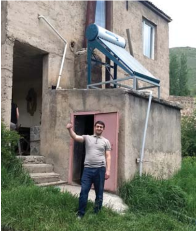
Արևային ջրասափացուցիչի տեղադրում Մեղրաձորի ուսումնասանկութային կենտրոնի սանիթին Installation of solar water heater on the roof of Meghradzor Educational and Cultural Center
